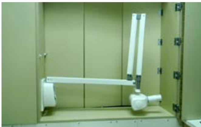
Rycina 162. Montowany do ściany stomatologiczny aparat RTG umieszczony w sali operacyjnej. Lampa RTG jest umocowana na długim ramieniu, co umożliwia jej ustawienie przy głowie pacjenta znajdującego się na stole operacyjnym
